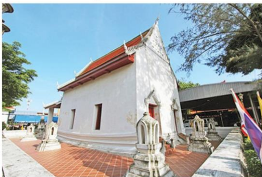
ฐานอาคารโบสถ์แอ่นโค้ง
